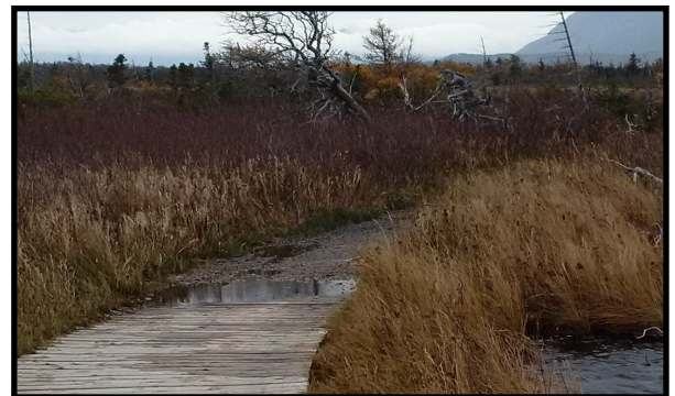
En haut : Promenades souvent inondées avant 2017 sur le sentier du lac Western Brook.
